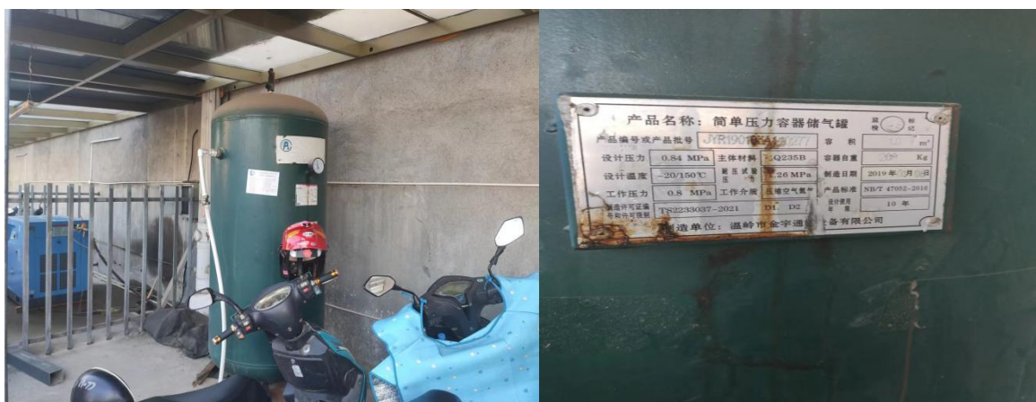
图 2.5-3 空压机及储罐
